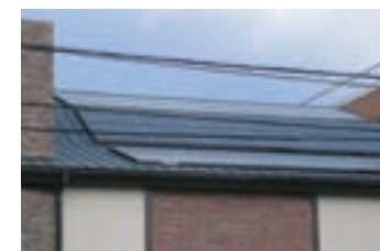
太陽光発電システム
